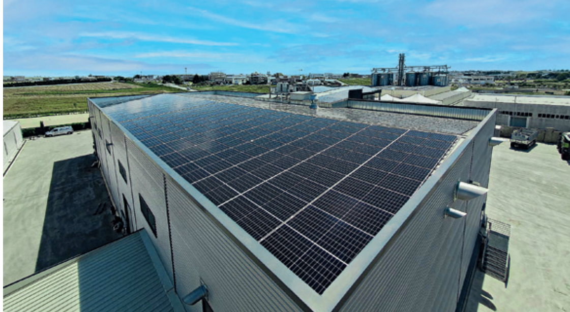
Impianto fotovoltaico su capannone in acciaio
